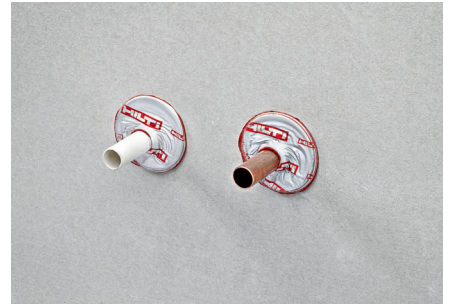
Muovi- ja metallisuojausputket
